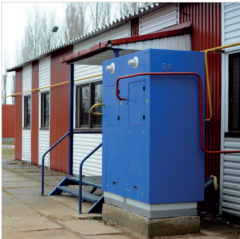
ТГУ-НОРД-30, отопление одноэтажных общежитий ОАО «Газпром газораспределение Тамбов» (всего установлено 10 ТГУ). Тамбовская область, пос. Первомайский
